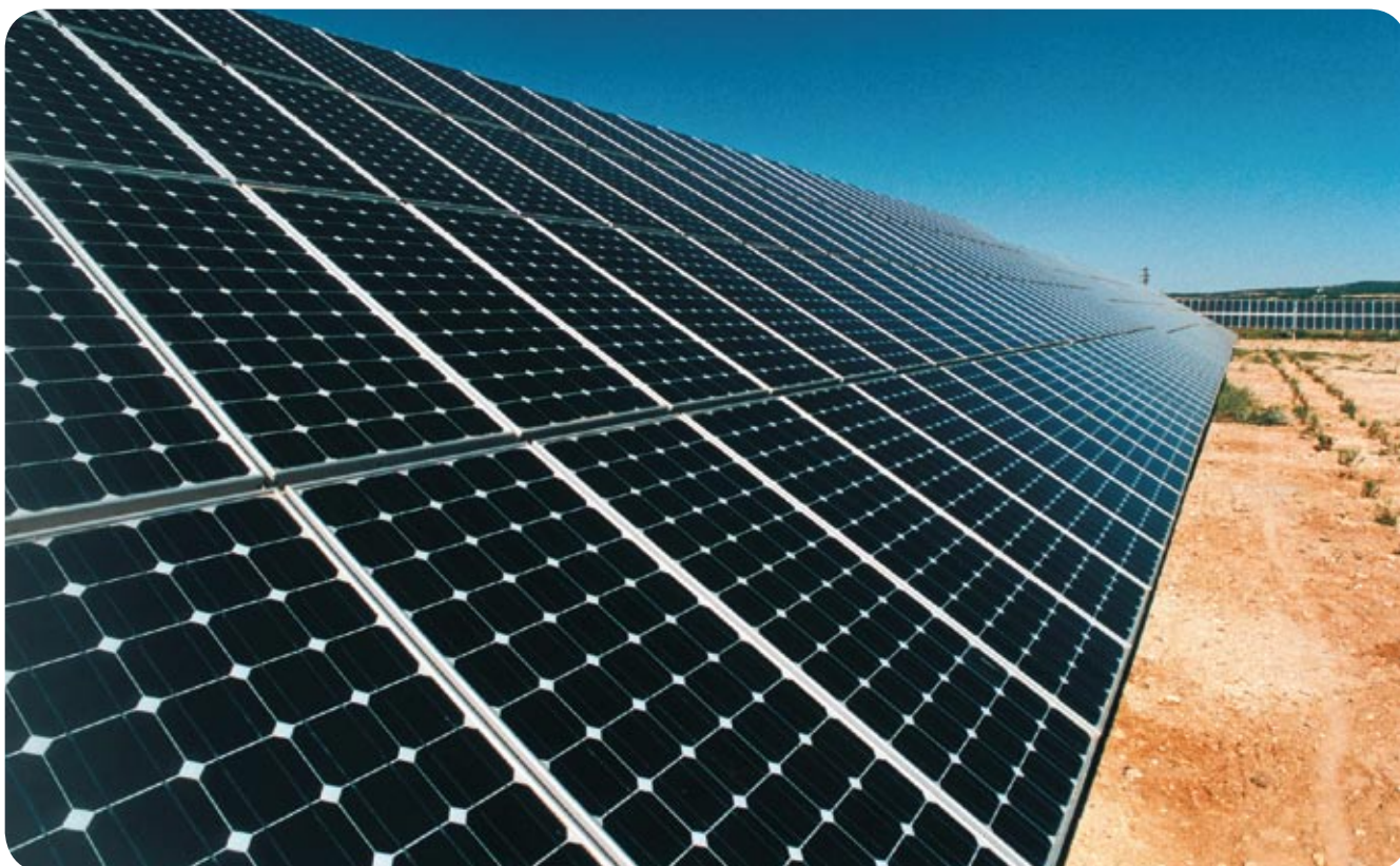
Paneles fotovoltaicos de la Central Toledo PV.
