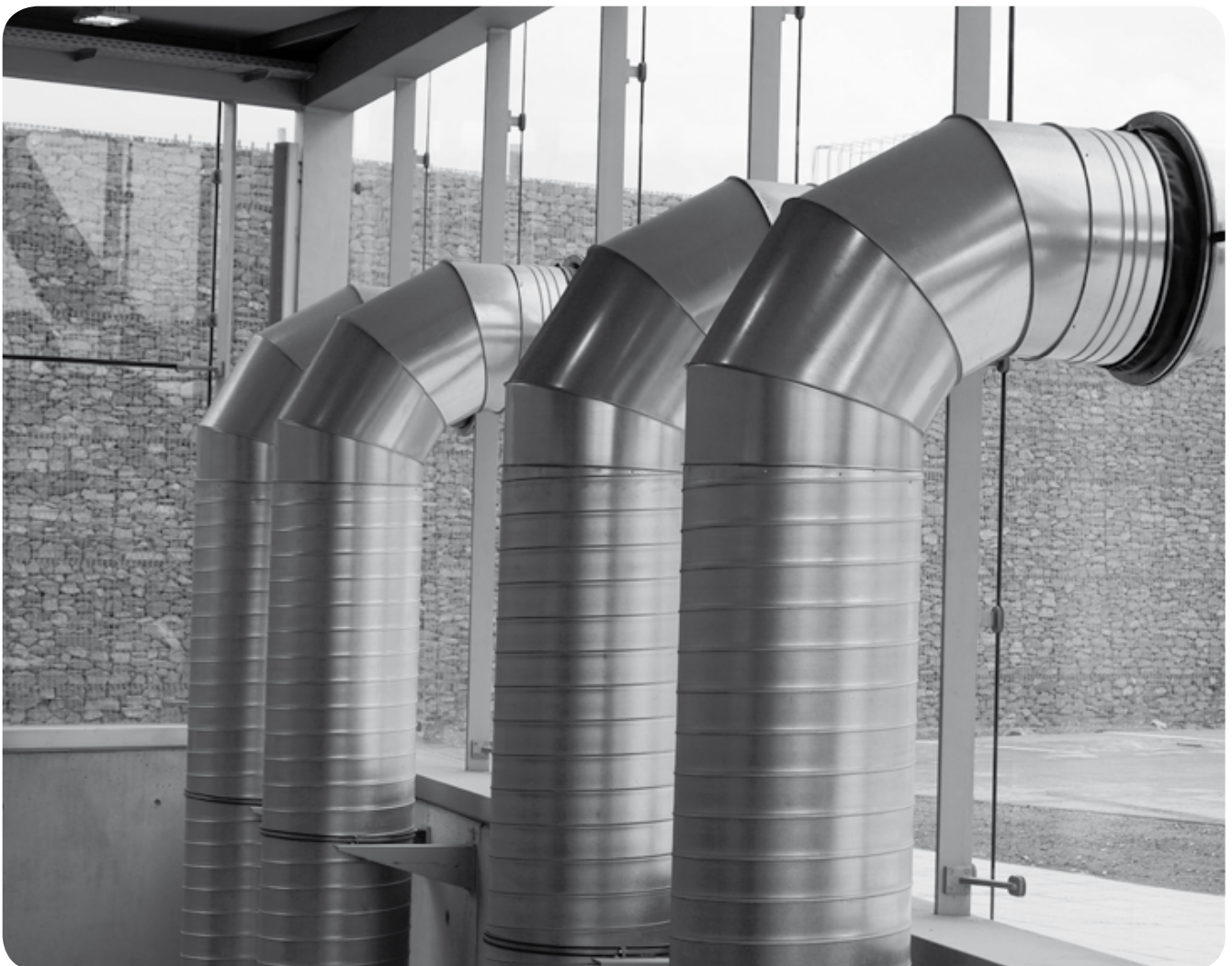
Ventilación forzada en estación de metro.
