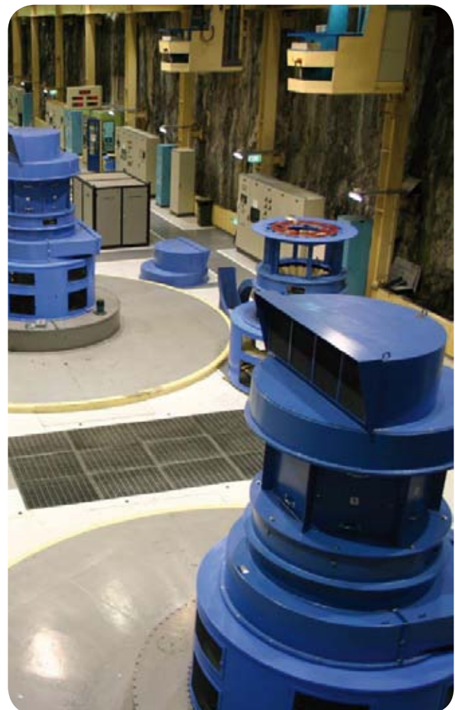
Turbinas verticales en una central hidroeléctrica.
