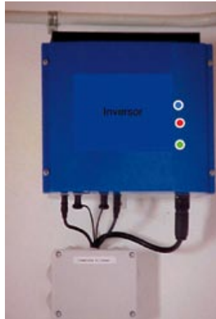
Unidad de acondicionamiento de potencia
