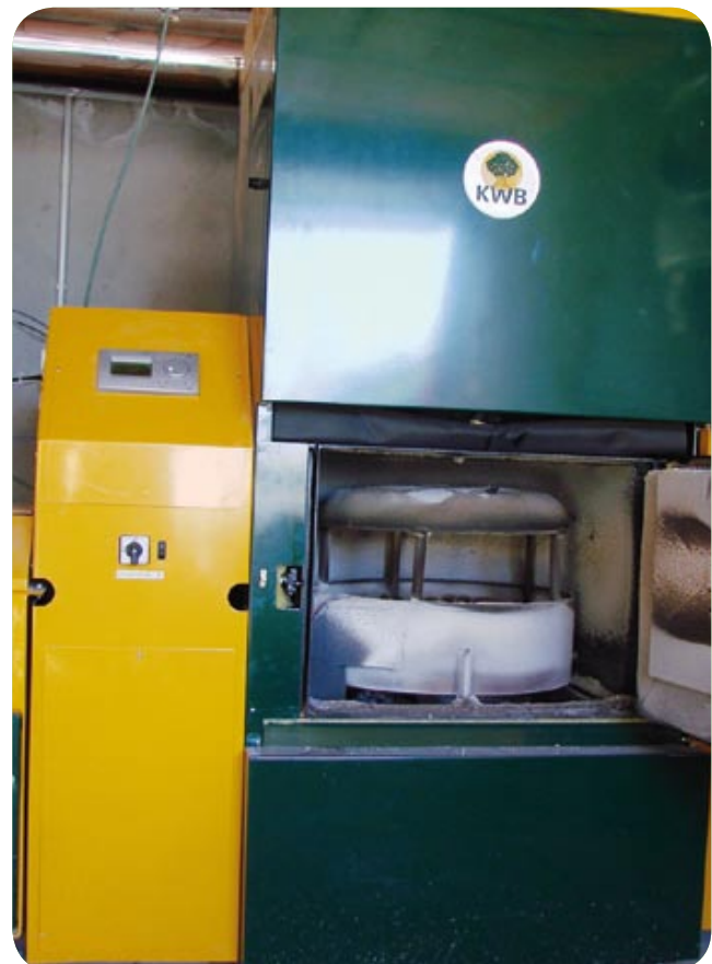
Caldera automática multi-combustible.
