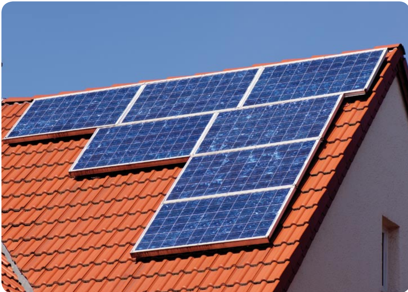
Instalación solar térmica para abastecimiento de agua caliente en una vivienda.
