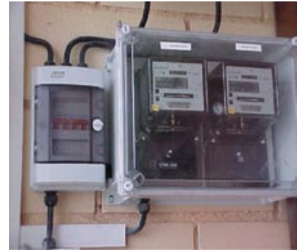
Cuadro eléctrico (protecciones y contadores)
