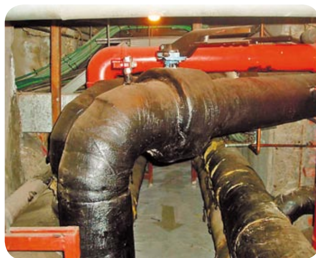
Red de distribución de vapor.
