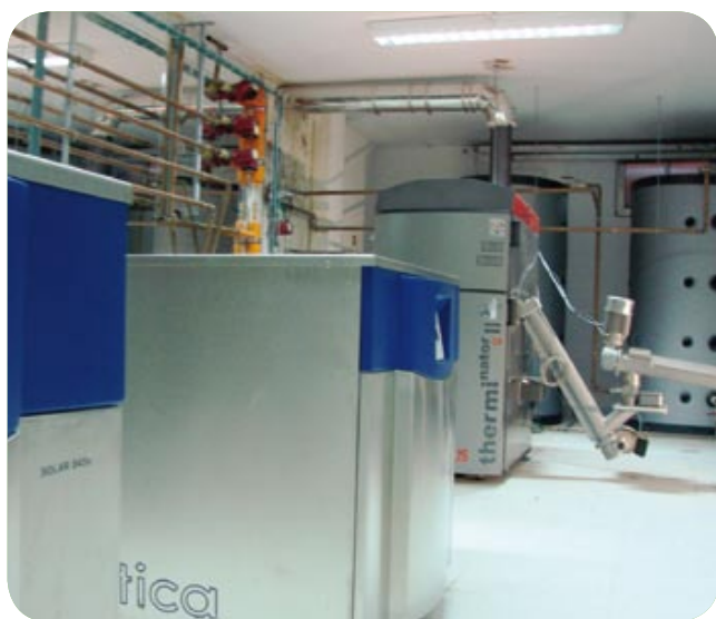
Sistema de climatización (Calor y frío) de la Casa de la Cultura de Viana de Cega, Valladolid.
