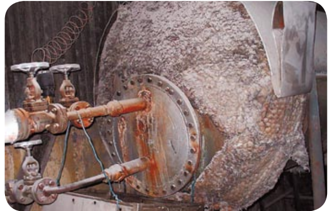
Caldera con aislamiento deteriorado.
