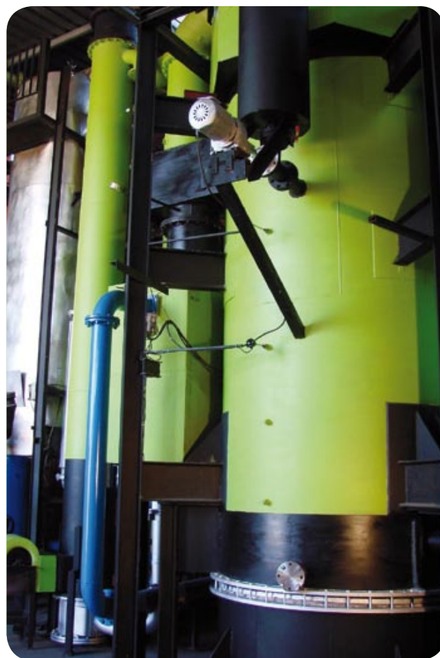
Gasificador de lecho fluidizado de Energía Natural de Mora.
